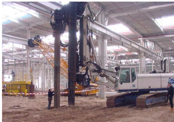
Fig. III.6 — Densification par vibrocompactage (Cas d'un sable lâche ayant 5m d'épaisseur d'un hall industriel construit en Belgique) (De Cock and Bottiau, 2004).
